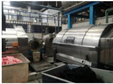
Foto No. 2. Área de lavado
